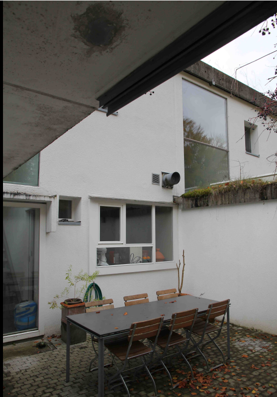
Siedlung Halen, Nordfassade Bauten der Moderne reagieren besonders empfindlich aufs Einpacken
